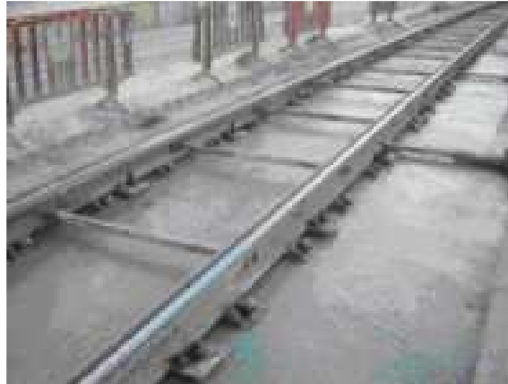
Şekil 1 Tramvay hattında elastik ray bağlantı elemanı montajı ve ray altına beton dökülmesi.
