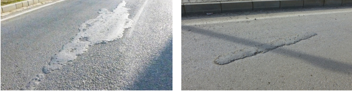
Şekil 5 Yol yüzeyine dökülen kalıntı örnekleri.
