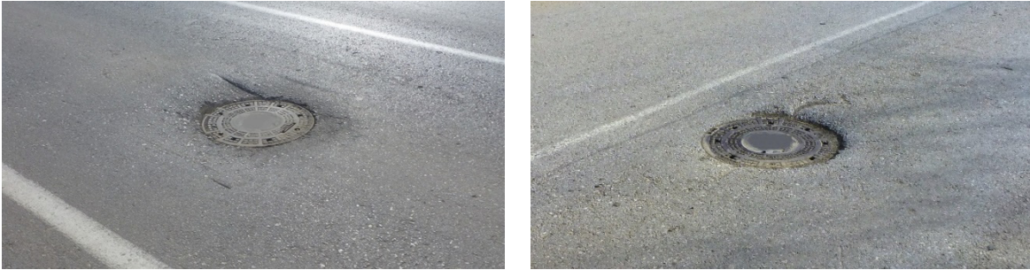
Şekil 3 Rögar kapaklarının yol kotuna göre düşük kotta yapılan imalat örnekleri.
