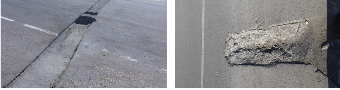
Şekil 2 Rijit malzeme ile üstyapı tamiri örnekleri.
